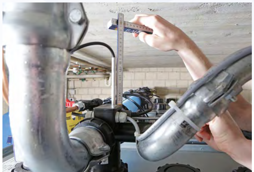
Der Grenzwertgeber wird nach den Vorgaben der abZ eingestellt.
